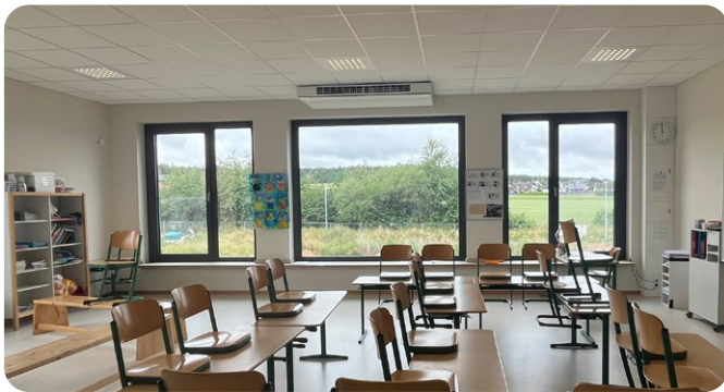
Gute Luft für konzentriertes Lernen: Das DUPLEX Vent 800 fügt sich nahezu unsichtbar in die Deckenkonstruktion des Klassenraums ein.
