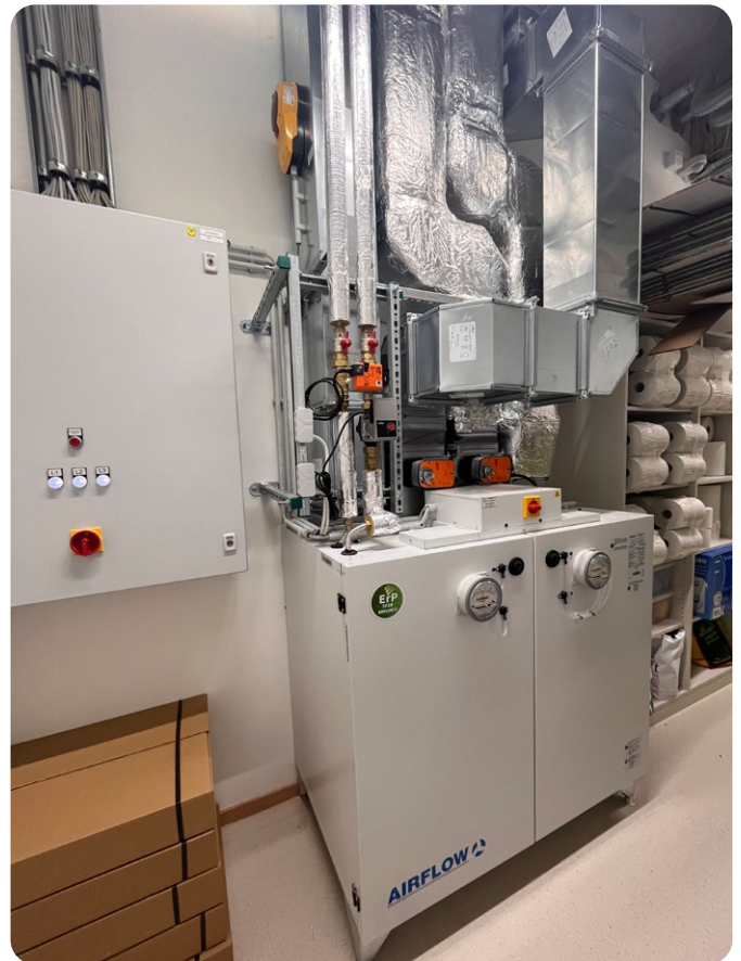
Für die innenliegenden Räume jedes Clusters übernimmt ein zentrales DUPLEXbase PT 900 die Lüftung – kompakt im Innenbereich aufgestellt.
