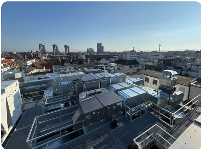
Auf dem Dach des innerstädtischen Bestandsgebäudes wurden insgesamt zehn Airflow Lüftungsgeräte verbaut.
