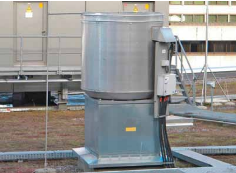
Bild: Airflow Lufttechnik
