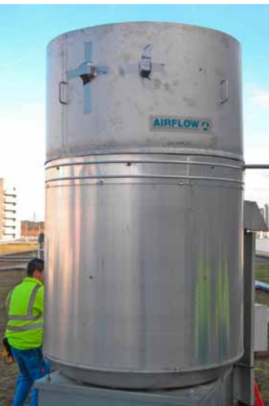
4 Die Messeinrichtung auf einem der Entrauchungsventilatoren zur Messung des Volumenstroms und zur Einstellung auf den erforderlichen Wert von rund 37 000 m 3 /h.
