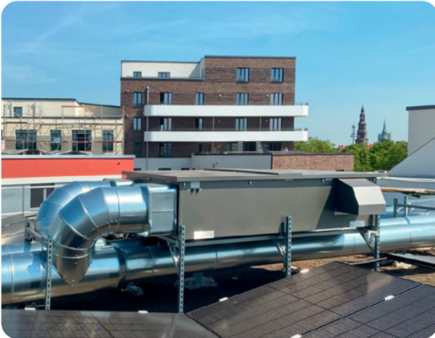
Die beiden auf dem Dach aufgestellten Lüftungsgeräte DUPLEX 1500 Multi Eco-N versorgen die 24 Wohnungen im Wohnquartier Ohe-Höfe zuverlässig mit frischer Luft.
