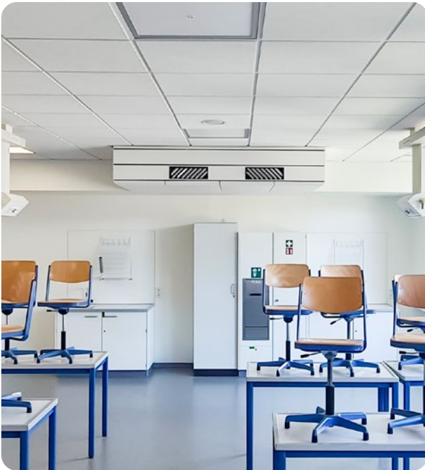
Durch den Wegfall aufwändiger Luftkanäle war der Installationsaufwand in den Klassenräumen gering.
