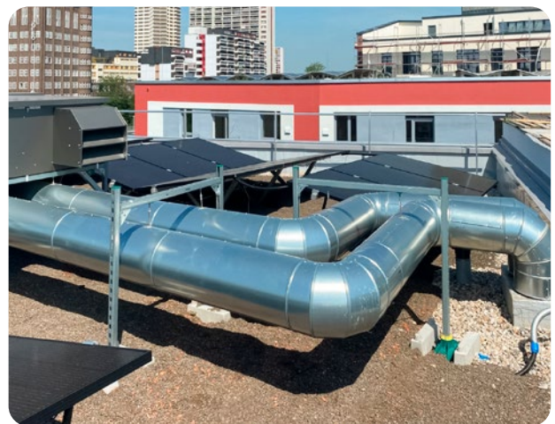
Über zentrale Versorgungskanäle gelangt die Frischluft zu den einzelnen Übergabemodulen SMART Box und in die einzelnen Wohneinheiten.
