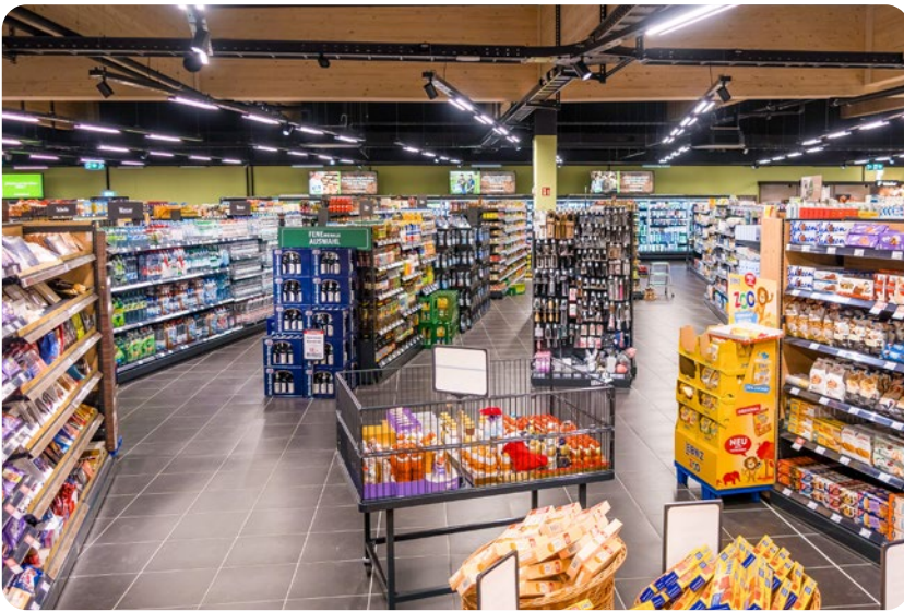
Während der Planungsphase galt es, die Anforderungen an die verschiedenen Bereiche im Supermarkt wie Backofen und Kühltheke im Blick zu behalten und das System aus Zuluft und Abluft perfekt darauf abzustimmen und auszugleichen.
