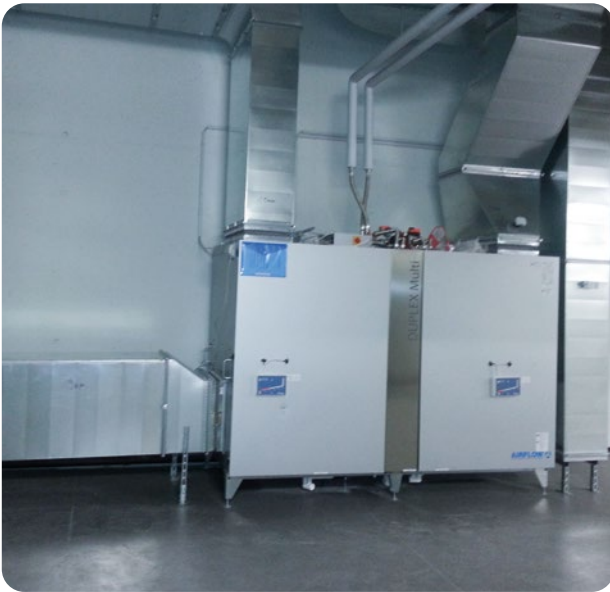
Genug Platz dank vorausschauender Planung: Das DUPLEX Multi 2500 versorgt Saal 4 mit frischer Luft. Dabei kann es den Kinosaal nicht nur kühlen, sondern im Umluftmodus auch schnell erwärmen.
