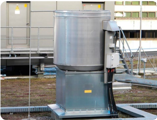
Einer von insgesamt 86 Entrauchungskaminen auf dem Dach des Terminals. Diese besitzen keine eingebaute Messeinrichtung. Deshalb mussten die Volumenströme mobil gemessen werden.
