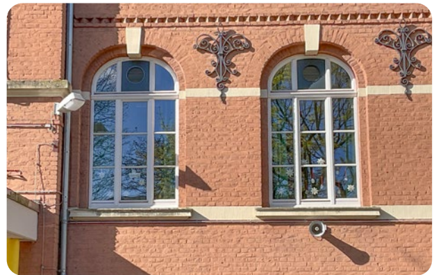
Von außen quasi unsichtbar: Die Zugänge für Außen- und Fortluft integrieren sich perfekt in die Fassade.
